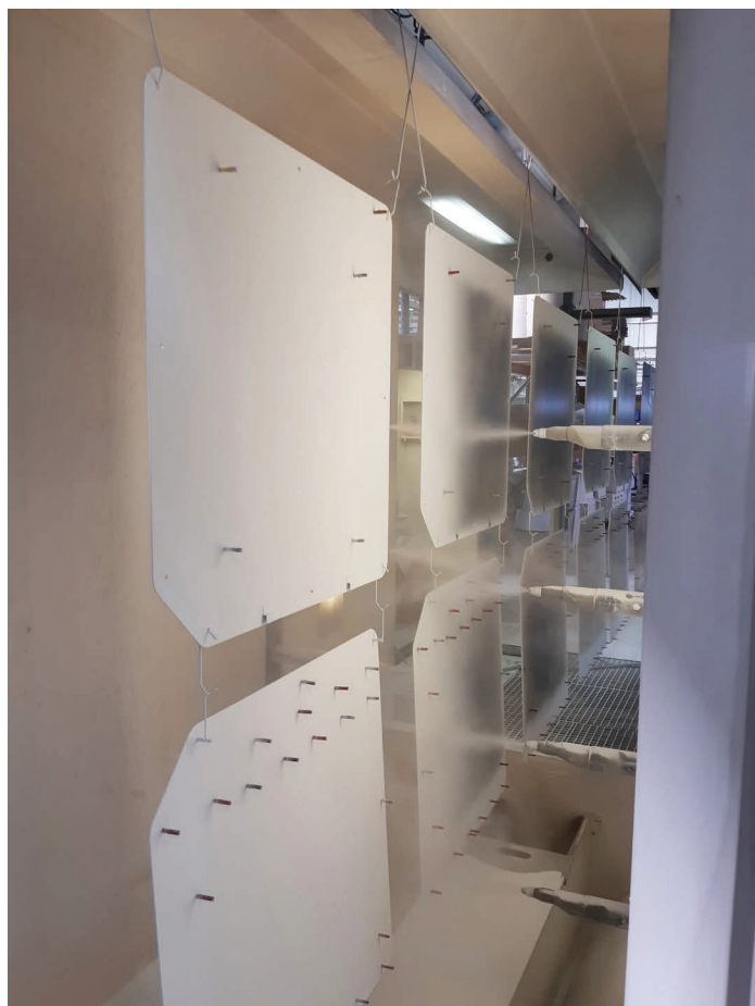
Beschichtungsanlage bei GSO
